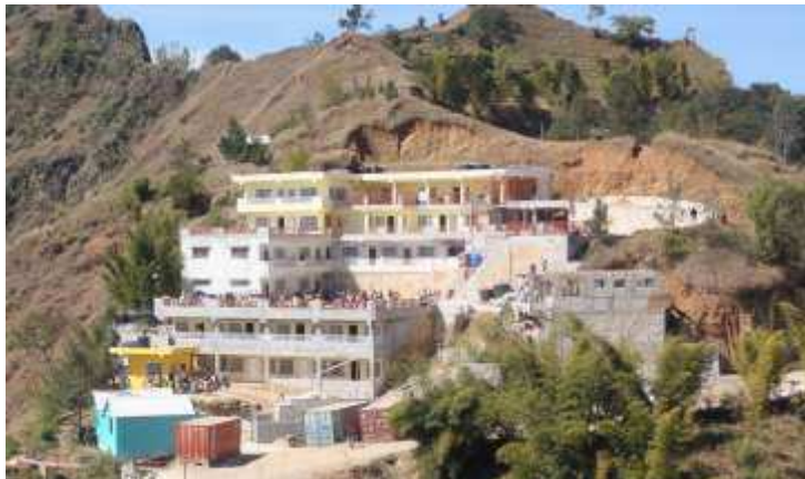
Ecole Soleil de Hollande met rechts de bouw van de nieuwe keuken en het kantoor
